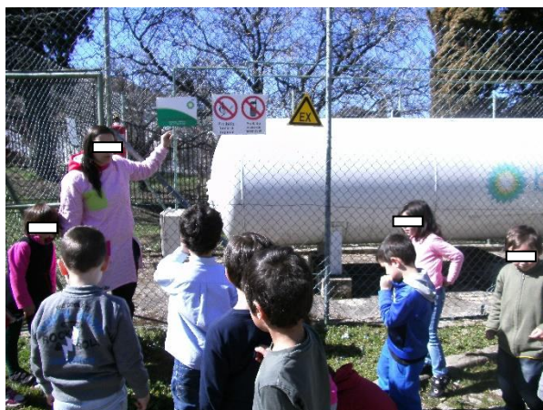
Figura 8 - Depósito de gás
