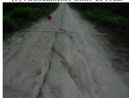
(d) Percurso de erosão.
