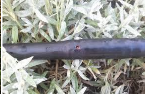
Figura 17 – Pormenor do gotejador na rampa.
