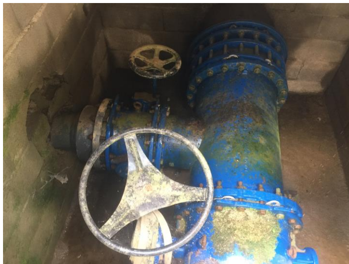
Figura 11 - Conduita de abastecimento de 1000 mm com uma saída de 500 mm
