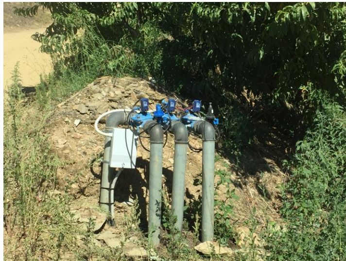
Figura 15 – Electroválvulas à entrada do porta-rampas
