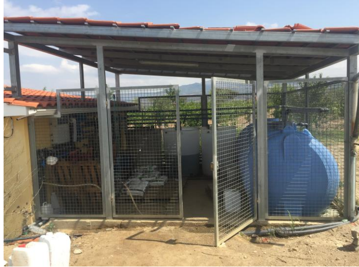
Figura 19 – Sistema de fertirrigação
