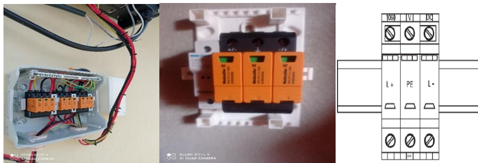
Figura 18: Descarregador de sobretensão, Fonte: IPB
