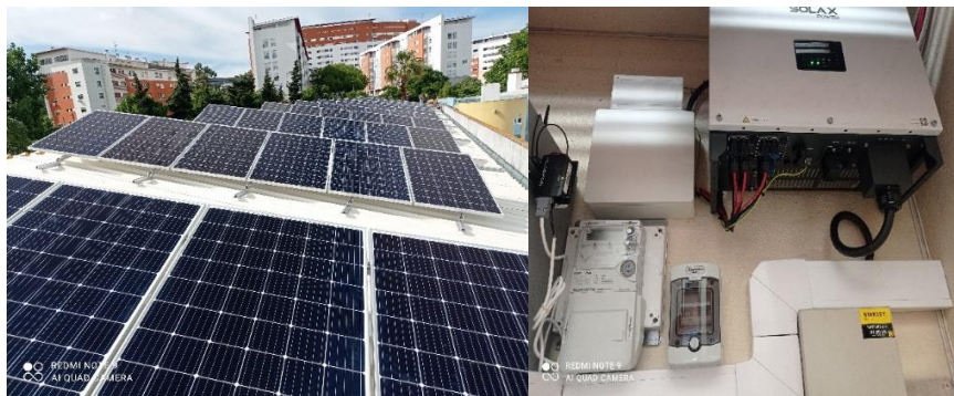
Figura 60: Instalação feita na escola
