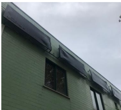
Figura 4.19 - Painéis Solares Termodinâmicos.
