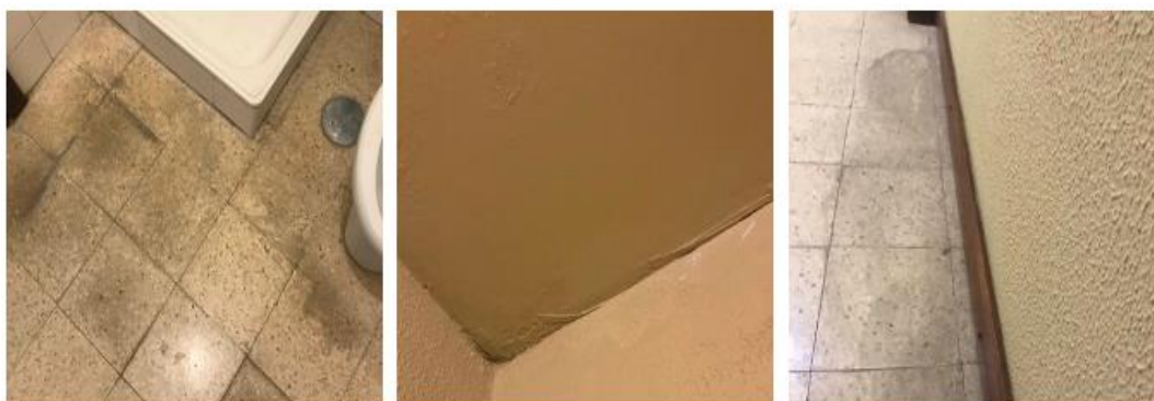
Figura 4.20 - Fungos e Infiltrações presentes em Paredes, Pisos e Tetos.
