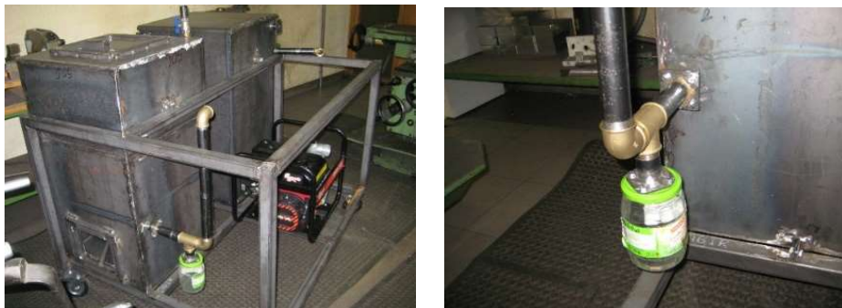
Figura 34 – Filtro de purga
