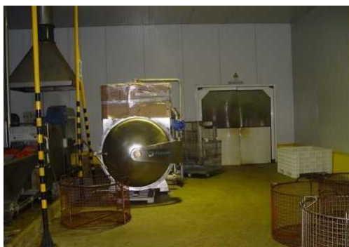
Figura 8 – Sala de esterilização e lavagem [16].
