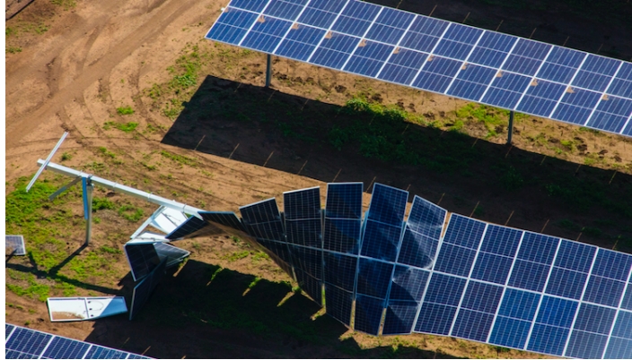
Figura 2.21: Os módulos retorcidos. Danos sofridos no local do Oakey 2. [38]
