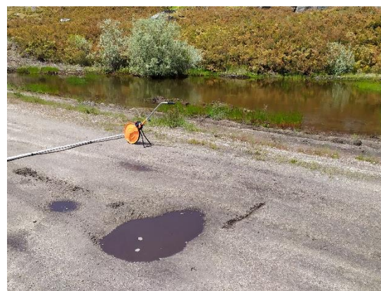
(d) Bueiros inexistentes
