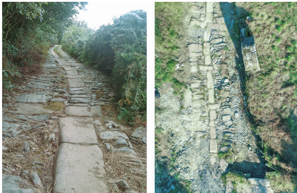
Figura 5 – Troço lajeado da Via do Marão junto ao Arco Memorial. Devido à ação das águas invernais do Ribeiro dos Azibais, desviado do seu curso natural para o caminho, esta calçada está muito degradada, necessitando de obras urgentes de consolidação e restauro.
