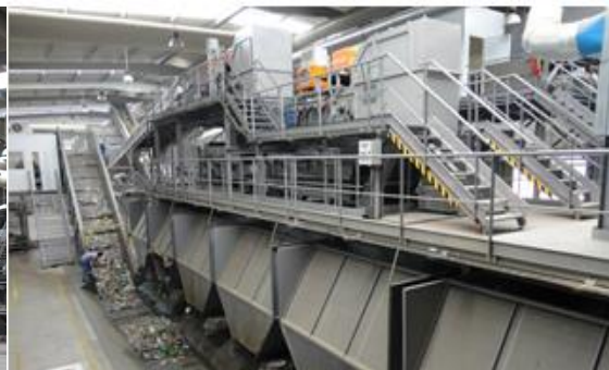
Figura 10 - Bunker de recepção de óticos do tratamento mecânico da UTMB de Urjais
