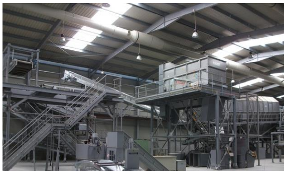
Figura 9 - Equipamento mecânico da UTMB de Urjais
