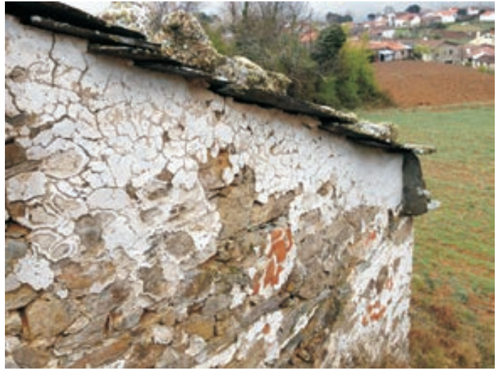
Deterioração generalizada dos rebocos
