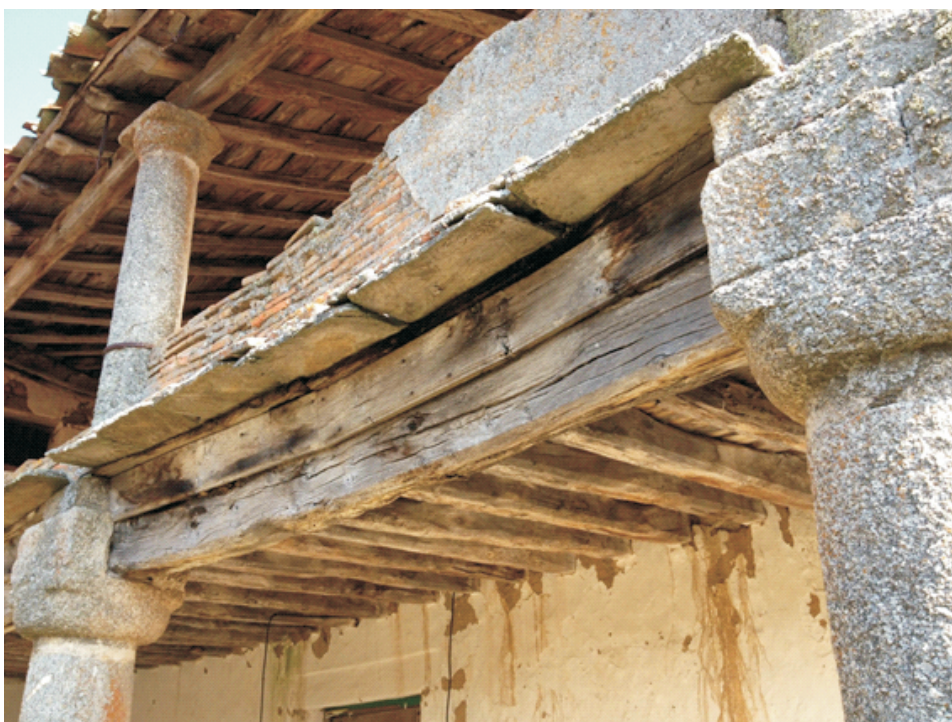
Deterioração da madeira
