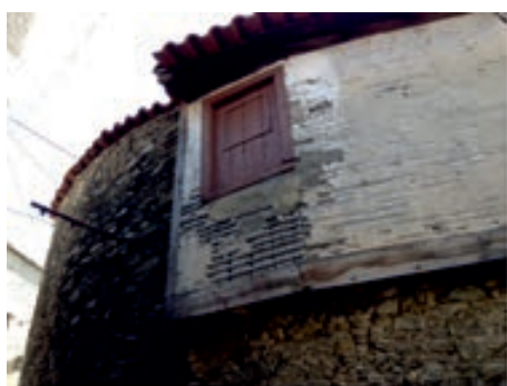
Destacamento do revestimento do tabique
