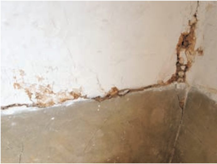
Fendilhação e desagregação dos revestimentos
