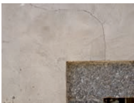
Fissura em reboco
