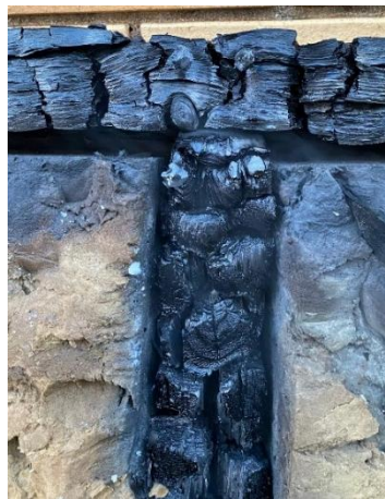
Figura 58. Montante de madeira após o Ensaio 2.
