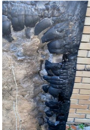
Figura 55. Lã de rocha preservada junto ao montante carbonizado.
