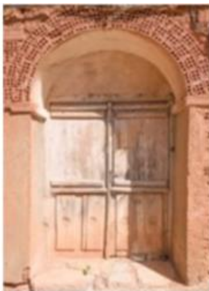
Figura 5 - Arco feito com tijolos furados. Fonte: Imagem retirada do Google.
