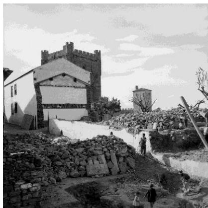
Fig. 8 - Demolição do Quartel militar do Batalhão de Caçadores nº 3, 1964 (fotografias do fundo documental SIPA)
