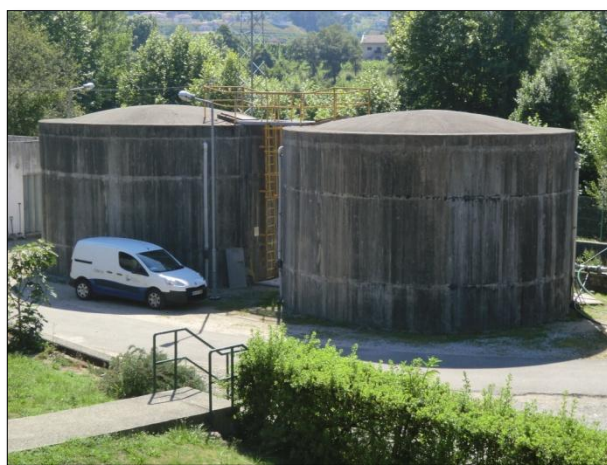
Figura 25 - Digestores anaeróbios de lamas - ETAR de Celorico de Basto
