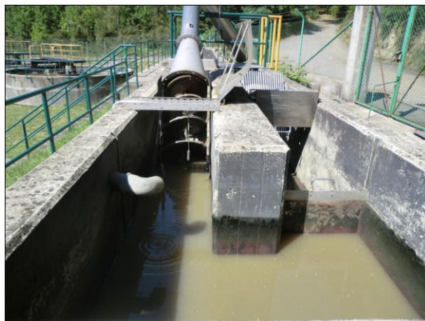
Figura 20 - Obra de entrada - ETAR de Celorico de Basto
