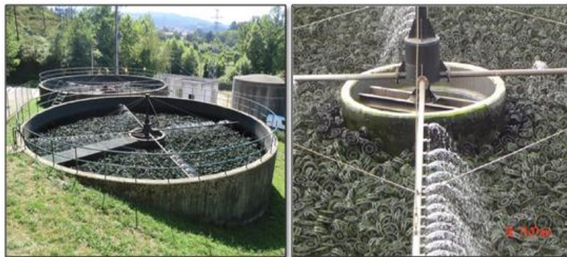
Figura 23 - Leitões percoladores - vista geral e pormenor - ETAR de Celorico de Basto
