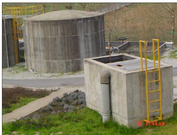
Figura 26 - Poço de bombagem de lamas - ETAR de Celorico de Basto
