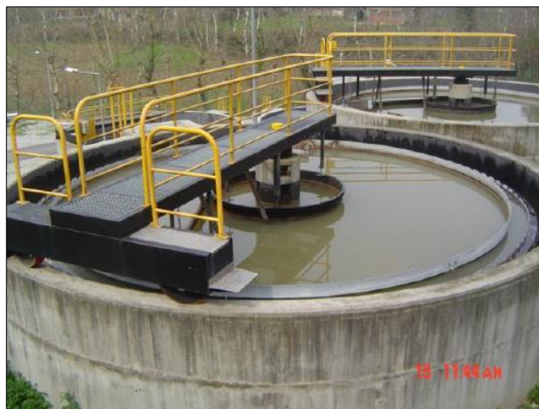
Figura 22 - Decantadores primários - ETAR de Celorico de Basto
