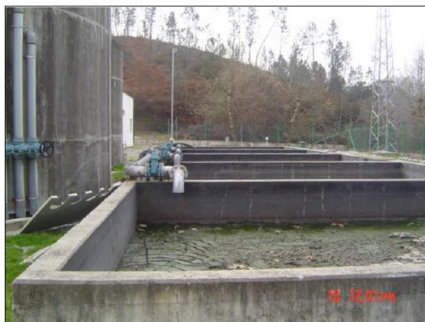
Figura 27 - Leitos de secagem de lamas - ETAR de Celorico de Basto
