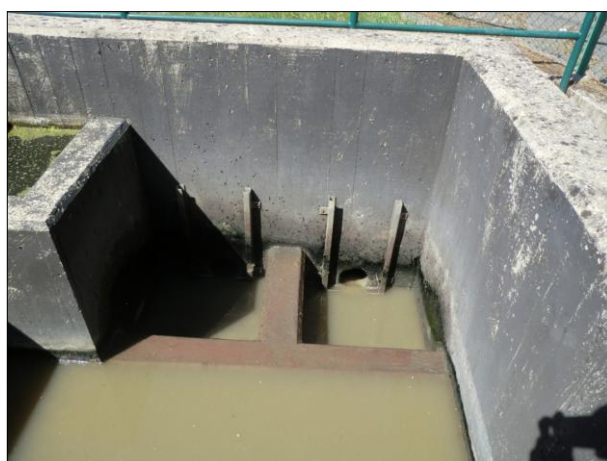
Figura 21 - Compartimento de estabilização e linhas de separação de caudais - obra de entrada - ETAR de Celorico de Basto
