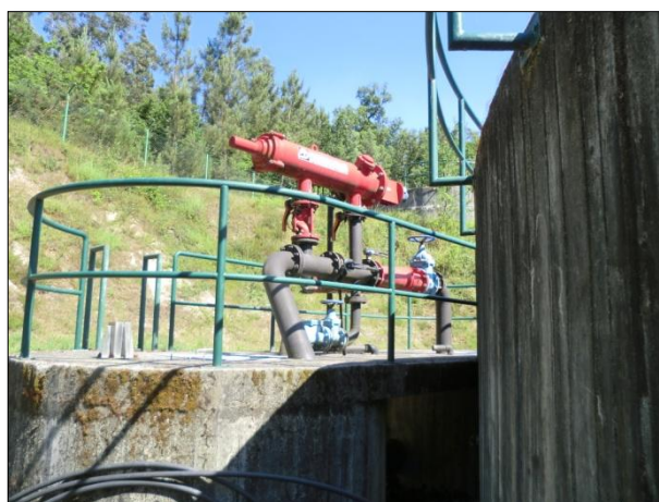
Figura 28 - Sistema de filtração - AMIAD - ETAR de Celorico de Basto
