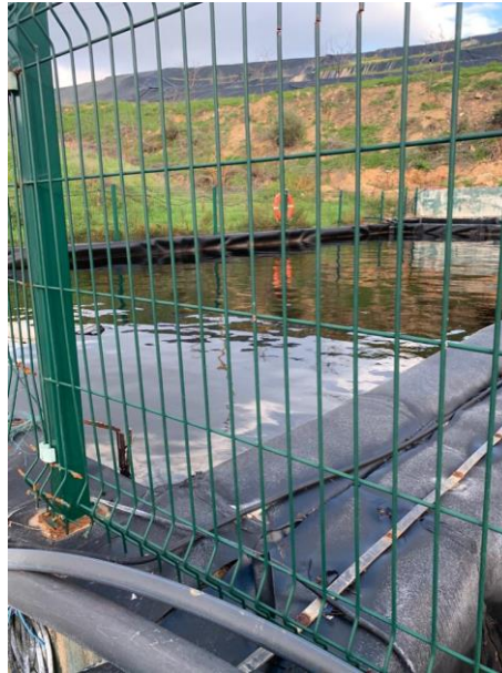
Figura 1 - Lagoa de homogeneização de lixiviado da empresa Resíduos do Nordeste.
