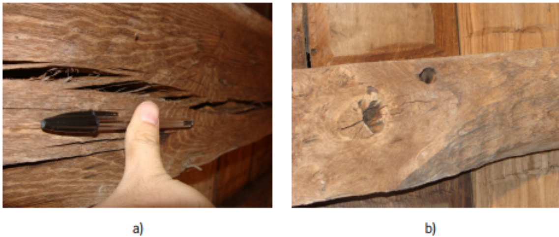
Figura 2.5: Identificação de defeitos da madeira: a) fenda de secagem; b) pequenos nós, [12].
