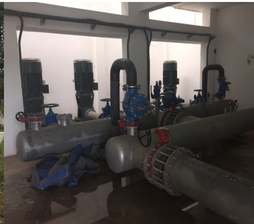
Figura 15 - Bombas de eixo vertical no interior da infraestrutura de captação
