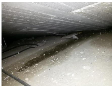
Figura 0-12 Infiltrações pela cobertura
