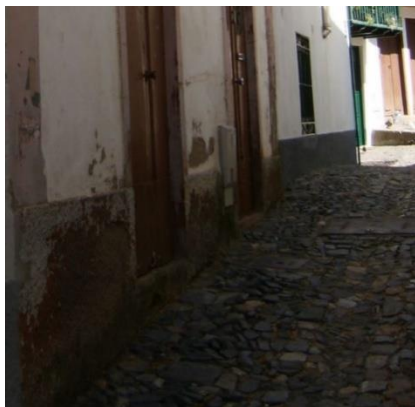
Figura 28 Exemplo de uma casa com destacamento de reboco e pintura.
