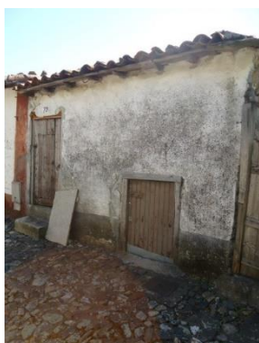
Figura 30 Exemplo de uma casa com existência de bolores na fachada exterior.
