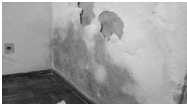
Figura 8 Exemplo de uma parede com manchas de humidade e expansão da tinta depois da evaporação da água.
