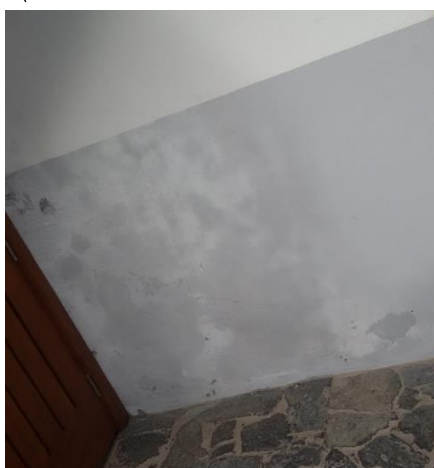
Figura 0-23 Plantas do edifício (Caso 11) e registo fotográfico das anomalias
