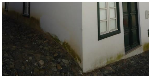
Figura 29 Exemplo de uma casa com existência de fungos na fachada exterior.
