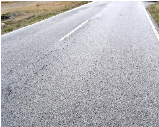
Figura 6.2) – Estado de degradação do pavimento ao km 66+200 (faixa da direita)
