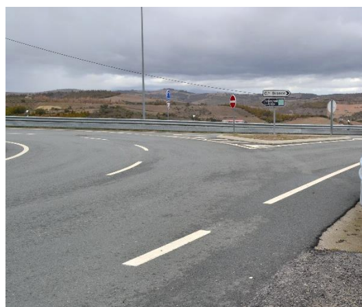
Figura 6.1 b) – Estado atual do pavimento no cruzamento EN 221 com a EN 315
