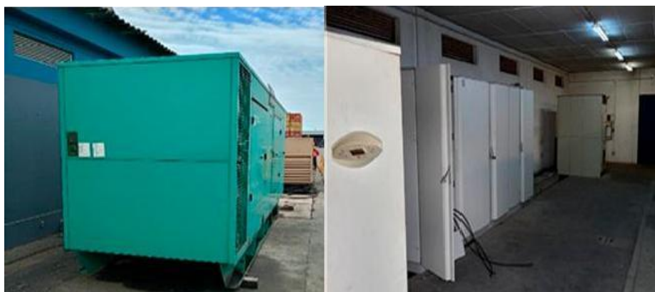
Figura 12: Infraestruturas elétricas da SOGESTER: Geradores de energia elétrica de emergência (esquerda) e quadros e instalações de distribuição elétrica interior (direita)
