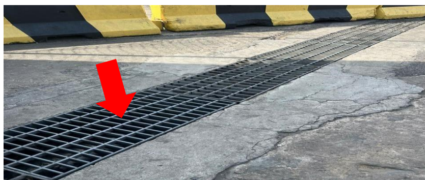
Figura 9: Canal de drenagem de águas pluviais localizado junto ao edifício administrativo da SOGESTER.
