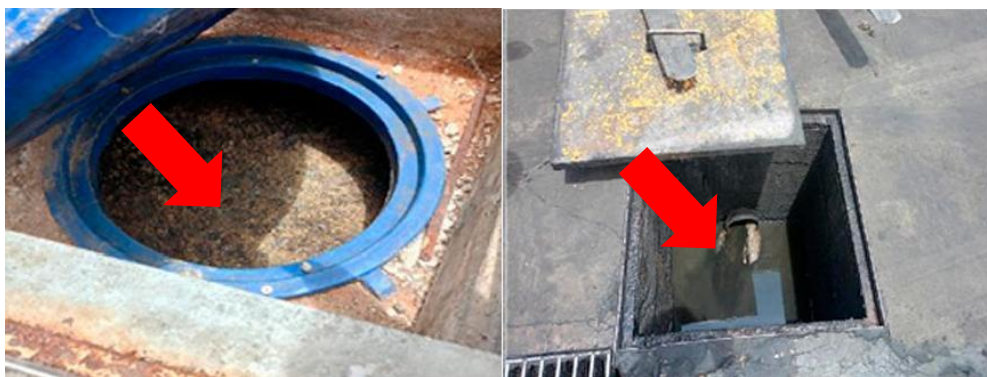
Figura 8: Infraestruturas de saneamento das instalações da SOGESTER: tampa de acesso à fossa séptica (esquerda) e caixa de visita com escoamento de efluentes (direita).
