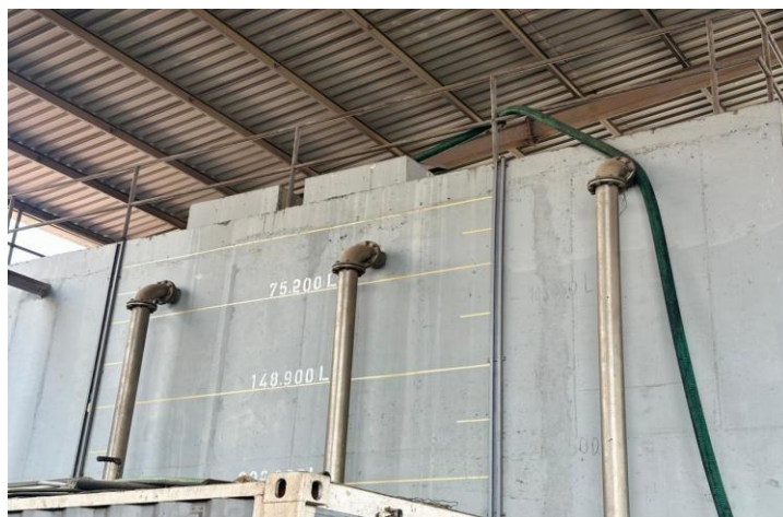
Figura 7: Reservatório de armazenamento de água das instalações da SOGESTER
