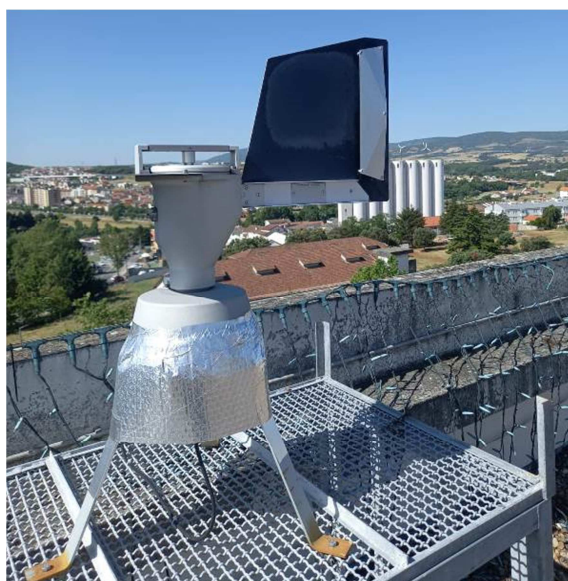
Figura 6 - Capturador volumétrico do tipo Hirst instalado na cobertura do Hospital de Bragança. Fonte: Autorial própria (2022).
