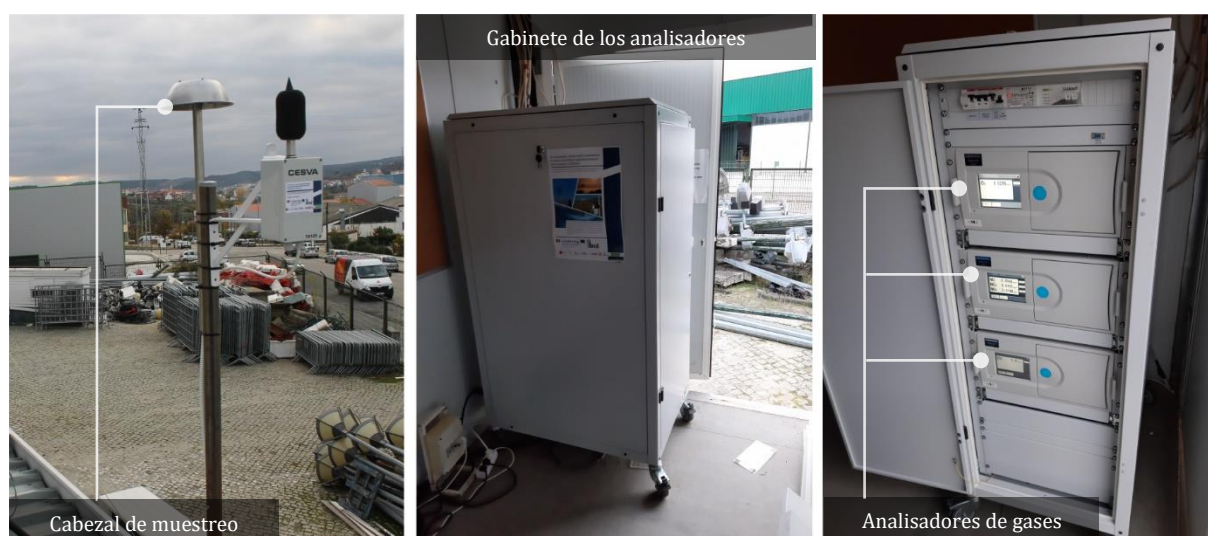
Figura 8 – Sistema de monitoreo de gas. (izquierda) sistema de entrada de aire responsable de apoyar y proteger los tubos de succión de aire ambiente hasta los analizadores; (centro) armario rack de los analizadores; (derecha) disposición de los analizadores de gas dentro del armario
