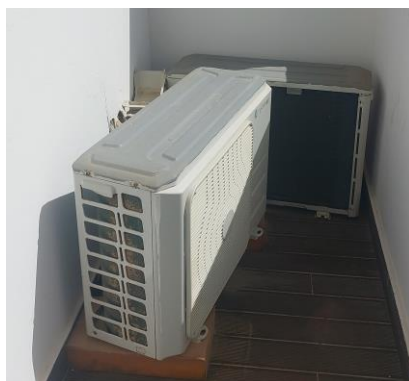
Figura 8: Exemplo de ar-condicionado instalado Fonte 10: Técnico de visita ao hotel
