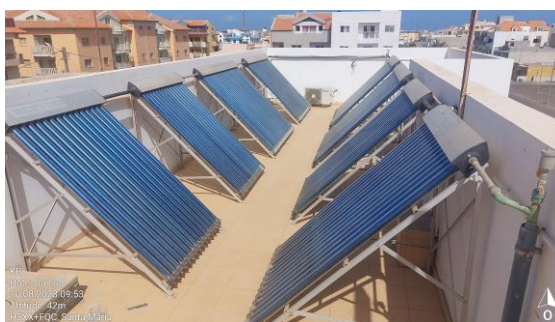
Figura 9: Sistema solar térmico instalado Fonte 11: Técnico de visita a instalação
