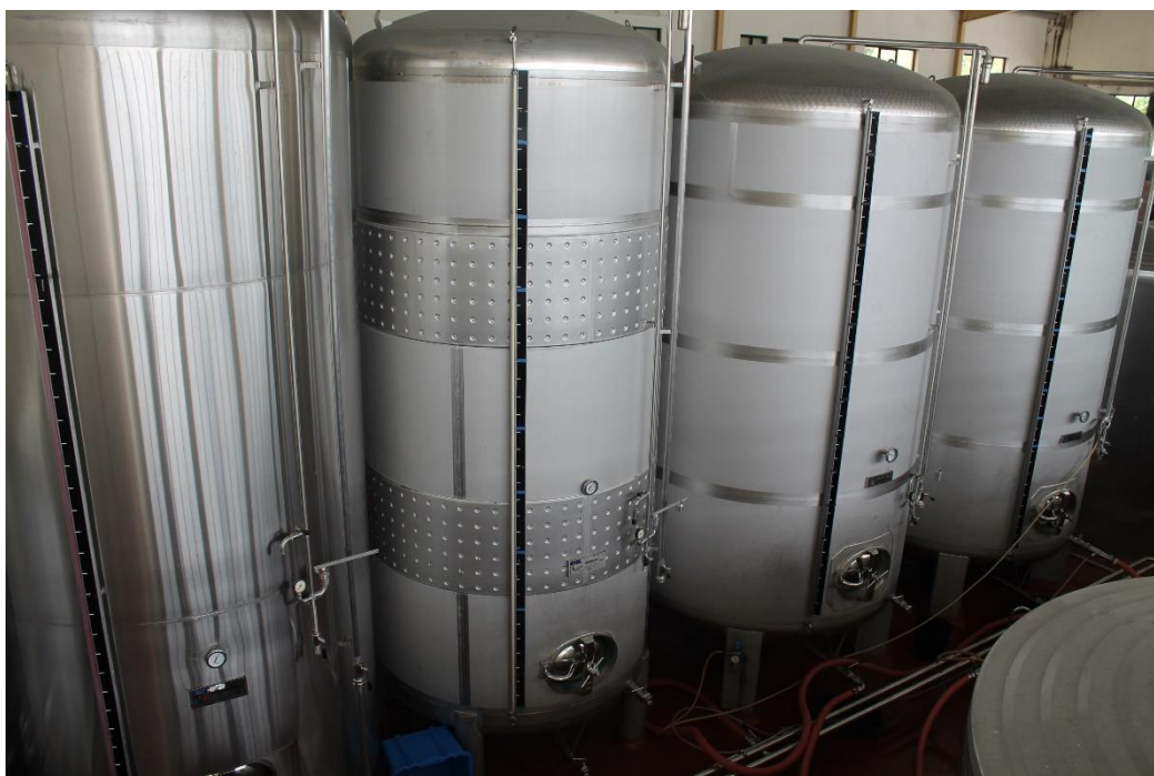
Figura 23 – Cubas utilizadas pelo sistema de refrigeração para estabilização de vinhos.
