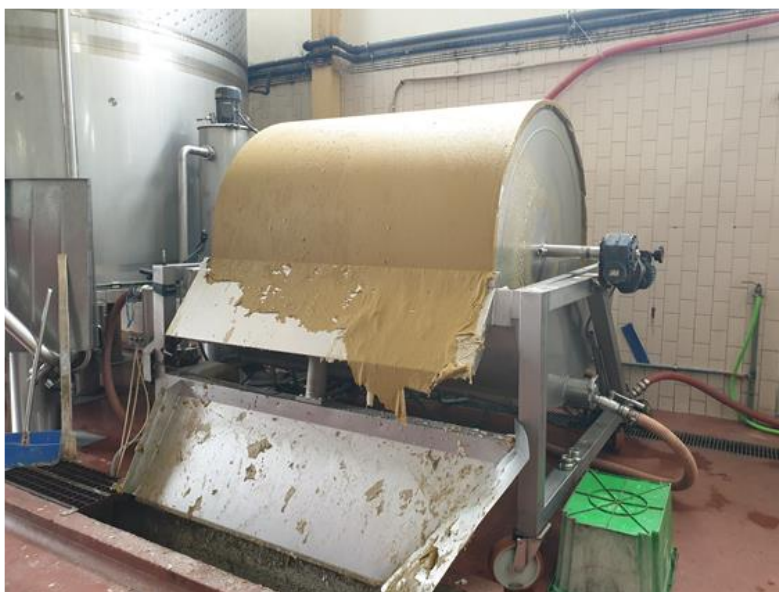
Figura 22 – Filtro de vácuo instalado na Quinta da Lixa.
