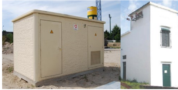
Figura 2 - PT Cabine Baixa e PT Cabine Alta
