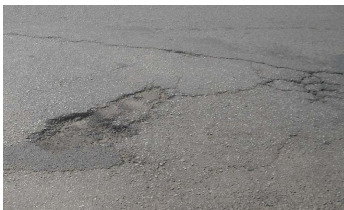
Figura 2.6 – Degradação tipo: pelada
