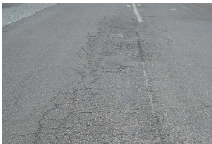
Figura 2.4 – Degradação tipo: rodeiras
