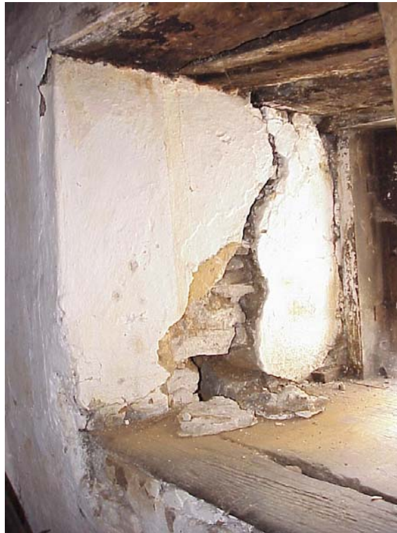
Figura 5.15 - Indícios de separação dos paramentos da parede ou de fraco imbrincamento da alvenaria (Fotografia 8).
