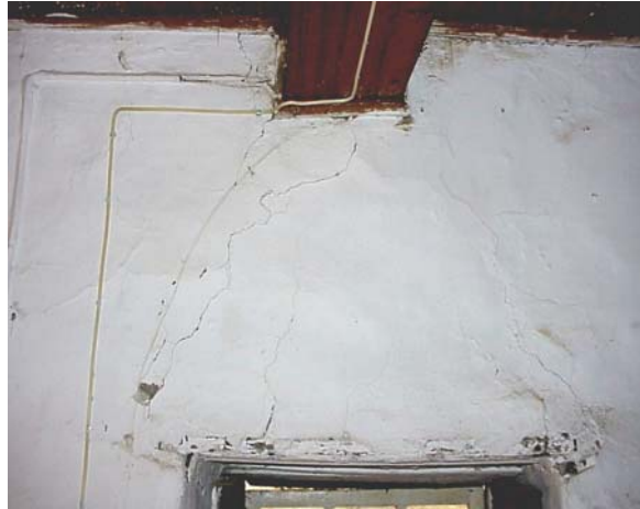
Figura 5.16 - Fendilhação, sobre uma janela, associada à deformação da padieira em madeira (Fotografia 9).
