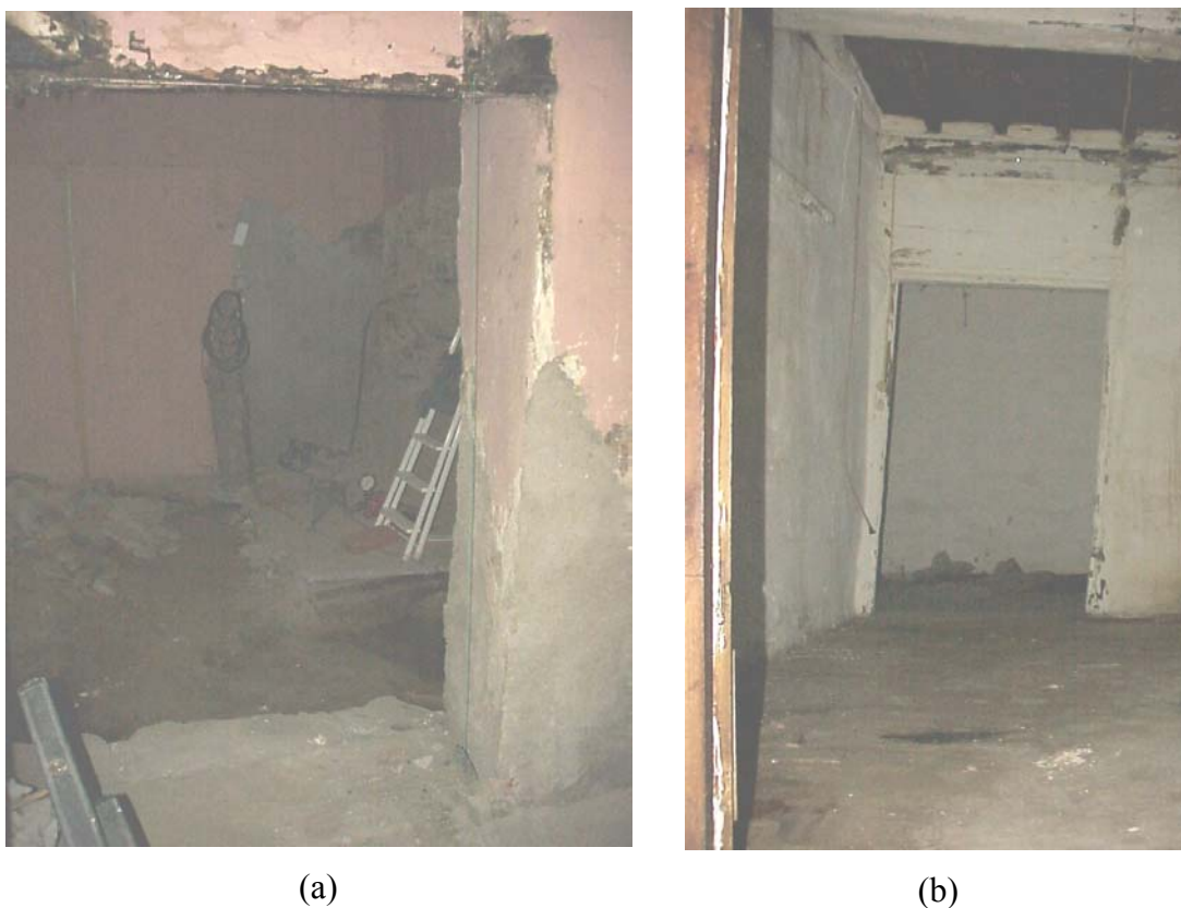
Figura 5.12 - Aspecto do desaprumo dos vãos de portas: (a) parede transversal no rés-do-chão (eixo2) (fotografia 5); (b) parede divisória no 1ºandar (eixo 4) (fotografia 6).
