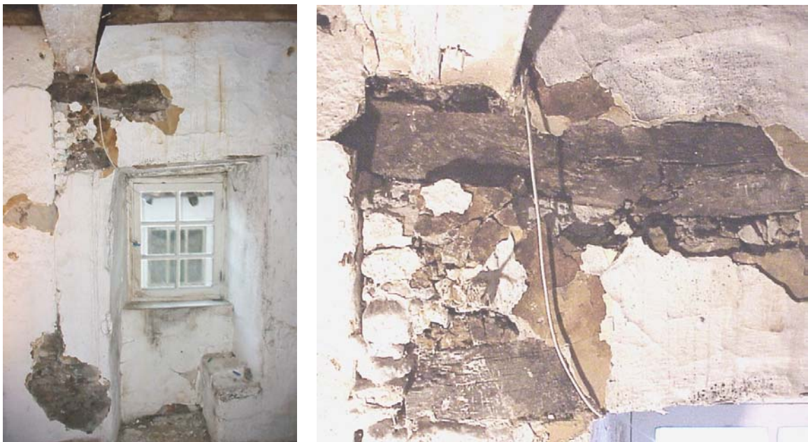
Figura 5.17 - Separação entre a parede e um tamponamento parcial de alvenaria para apoio da padieira em rotura (Fotografia 10).
