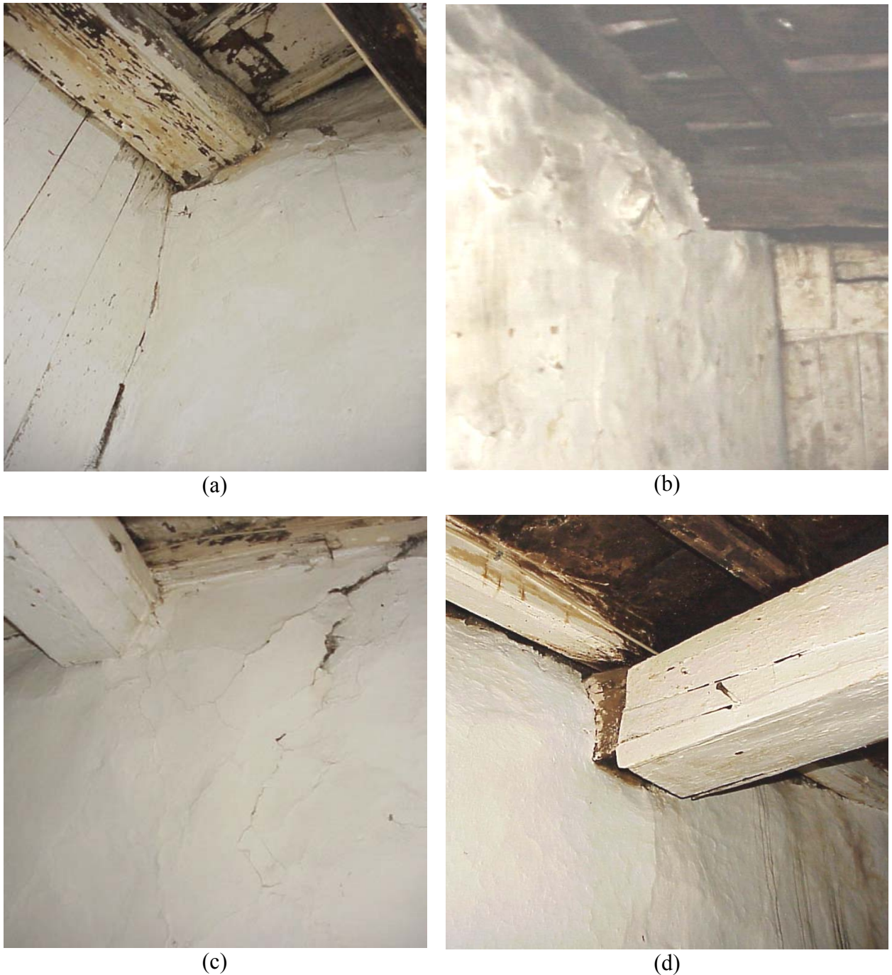
Figura 5.11 - Aspecto da parede de empena interior junto ao apoio das vigas do pavimento/cobertura: (a) fotografia 1; (b) fotografia 2; (c) fotografia 3; (d) fotografia 4.
