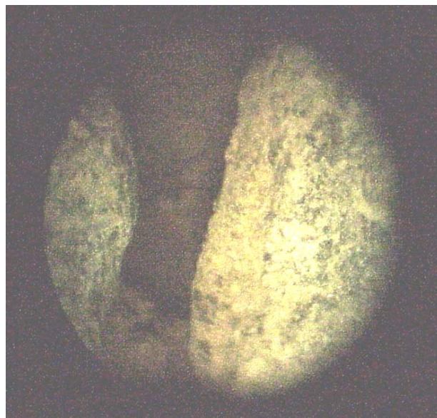
Figura 5.27 - Aspecto típico das observações com câmara boroscópica na janela 1: vazios e elementos desligados.
