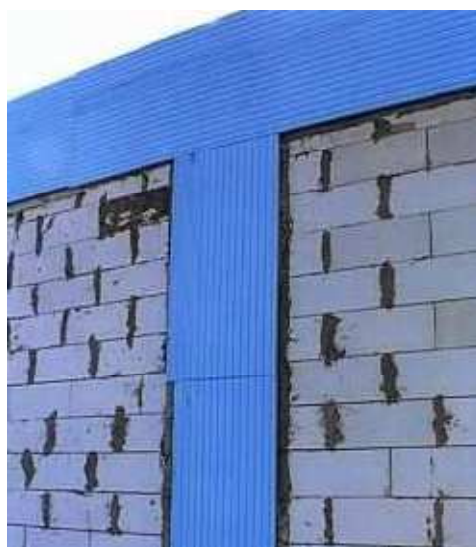
Figura 14 - Correção de uma ponte térmica na zona de um pilar e viga com recurso a poliestireno extrudido. [16]
