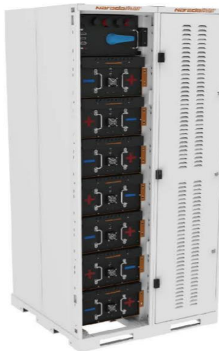
Figura 25: Bloco de baterias.
