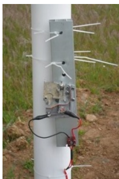
Figura 3.3.7: Visualização da carga fixa ao poste, utilizada para dissipar a energia elétrica.
