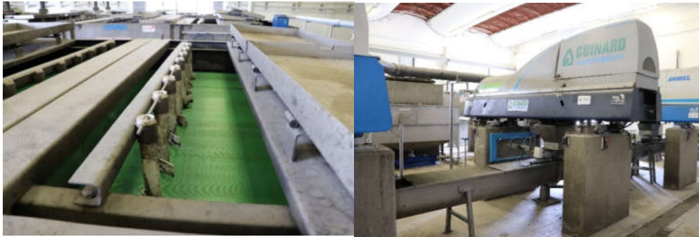
Figura 14 – Mesa de espessamento e centrífuga de desidratação
