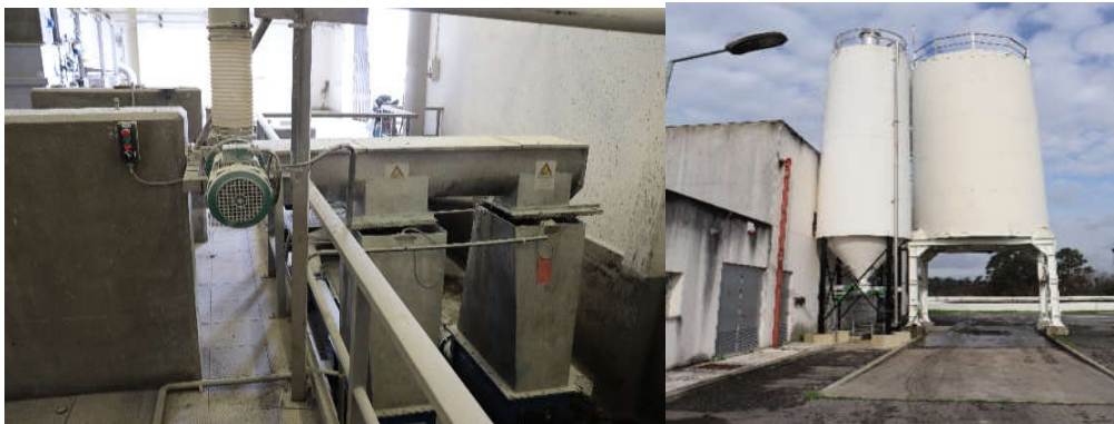
Figura 15 - Estabilização química e silo de armazenamento das lamas
