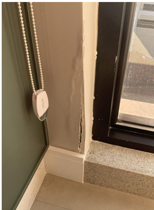
Figura 13: Infiltração em esquadria de alumínio- janela
