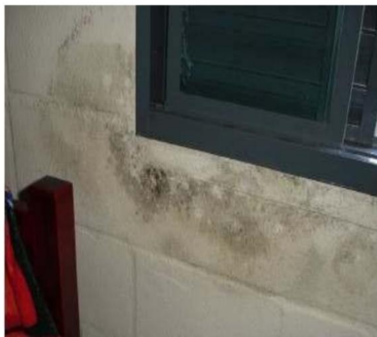
Figura 4 - Caso de umidade devido à infiltração na região próxima ao peitoril.
