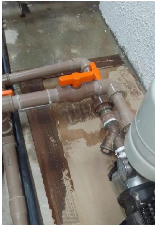
Figura 15: Vazamento em tubulação de água
