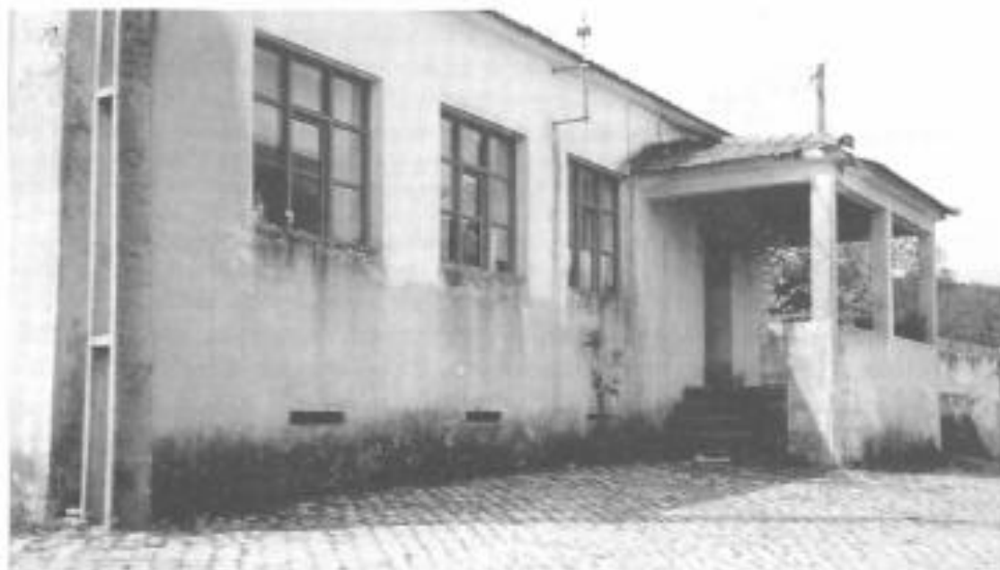
Fotografia 23 – Escola de Bragada, no concelho de Bragança. Construída, possivelmente, no ano de 1926, pertencente à tipologia do Período da República – Projecto tipo XXV. Fotografia tirada em 12.05.2002, onde podemos ver o estado de degradação do edifício e a falta de um espaço exterior (acesso directo para a rua).
