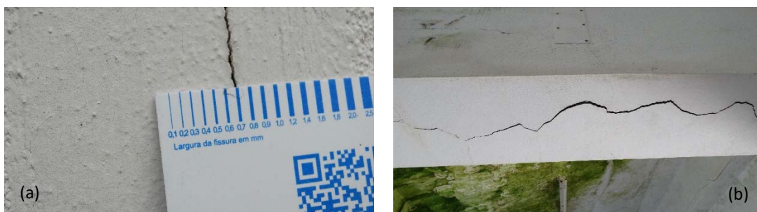
Figura 9 – (a) Medição da fissura f_4 e, (b) aspeto da fenda f_5
