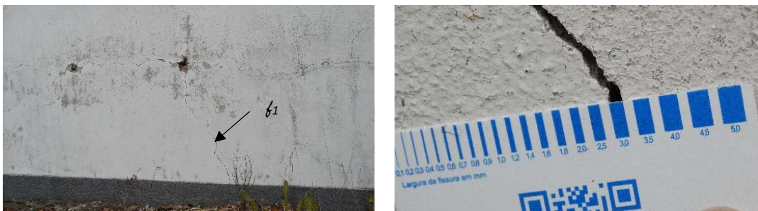
Figura 8 – Aspeto da fenda f_1 na parede exterior
