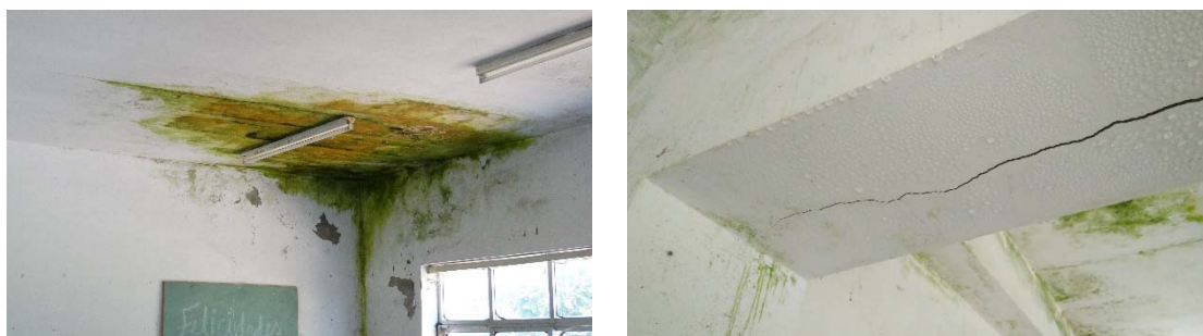
Figura 19 – (a) Presença de colonização biológica, (b) Condensações superficiais em revestimento
