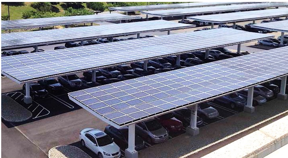
Figura 5 – Geração de Energia solar em estruturas de estacionamento em New Jersey nos Estados Unidos.
