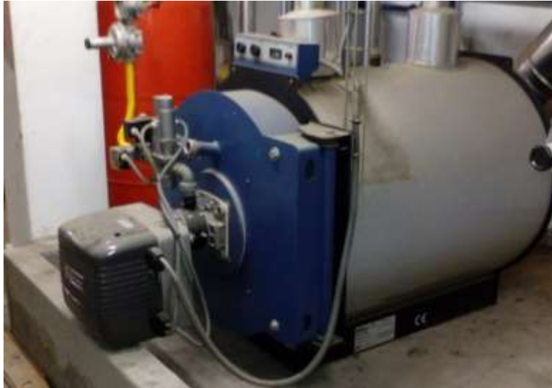
Figura 4-5-Caldeira e Queimador instalados.
