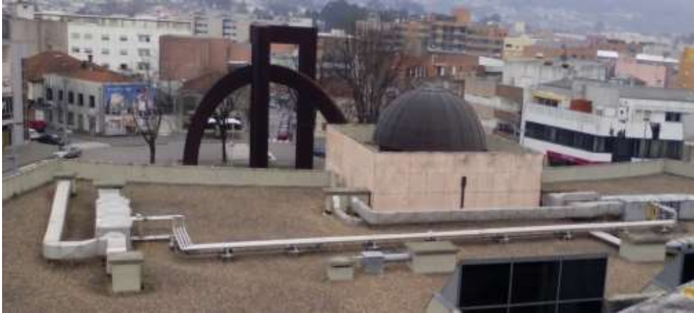
Figura 4-7-UTA's responsáveis pela ventilação no Bloco A.
