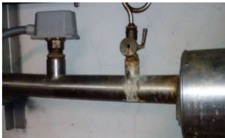
Figura 4-4- Problema no isolamento da tubagem.
