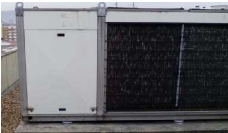
Figura 4-6Chillers Eléctricos instalados no topo do edifício.
