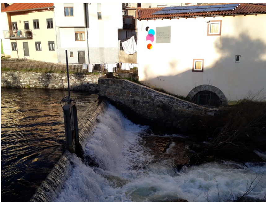
Figura 57. Estrutura de contenção do fluxo da água.
