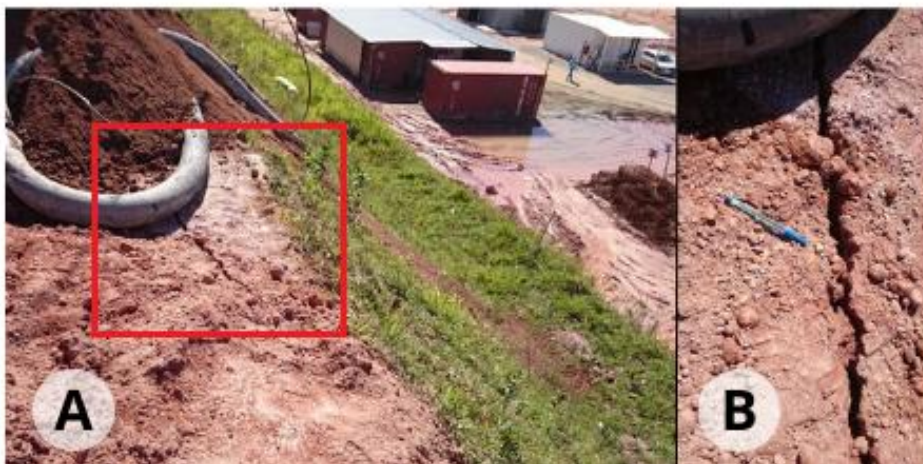
Figura 2.9 – Fenda de tração: a) Visão geral; b) Em detalhe
