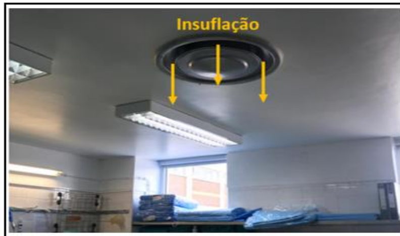
Figura 11. Sistema de ventilação mecânica na sala de sujos do serviço de esterilização.
