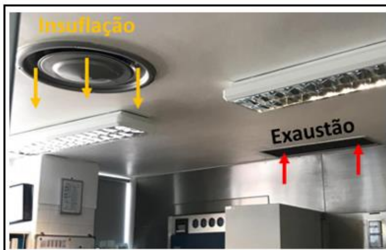
Figura 12. Sistema de ventilação mecânica da sala de limpos do serviço de esterilização.
