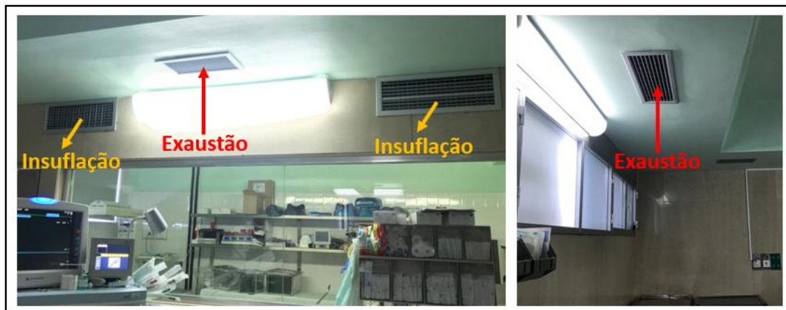
Figura 9. Disposição do sistema de ventilação mecânica na sala de cirurgia.
