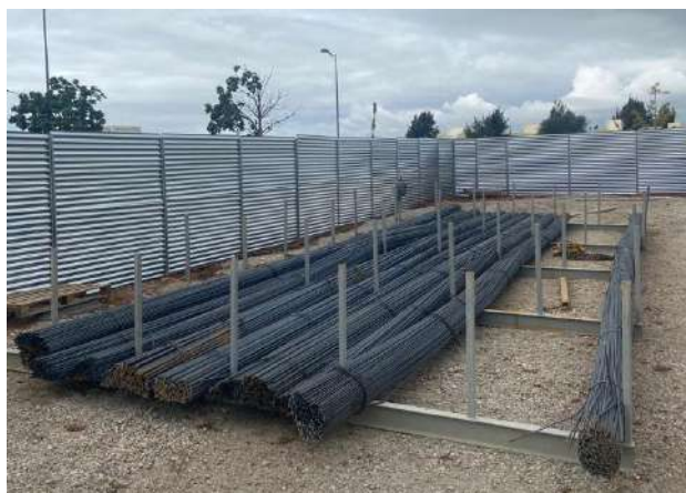
Figura 39: Baias separadoras de aço. Autoria própria, 2023.
