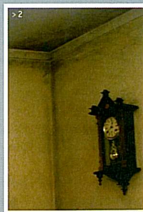
> Figura 2: Concentração de condensações e bolores na zona de um pilar de canto e na ligação entre as paredes exteriores e a laje de cobertura.
