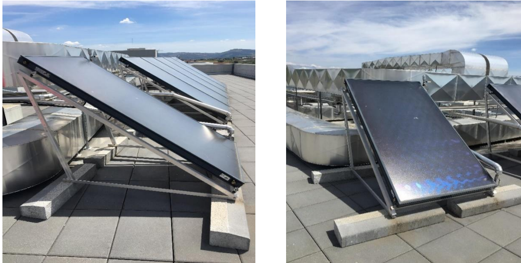
Figura 2.13 - Estrutura para superfície plana sobre maciços de betão (Brigantia ecopark).
