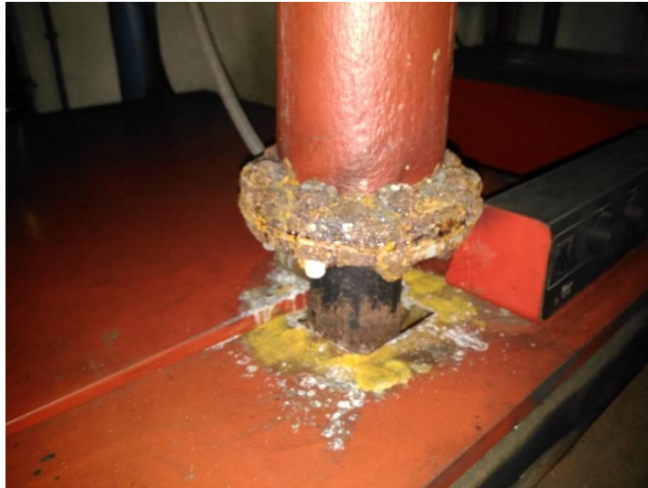
Figura 4.5- Problemas de isolamento
