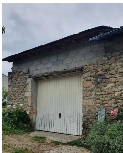
Figura 1 - Reabilitação feita de forma errónea
