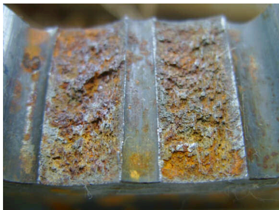
Figura 55 - Aparência da zona de ruptura de material.
