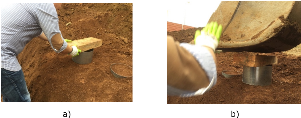
Figura 4.10 a) Posicionamento do amostrador e trave auxiliar ; b) Cravação com braço hidráulico.
