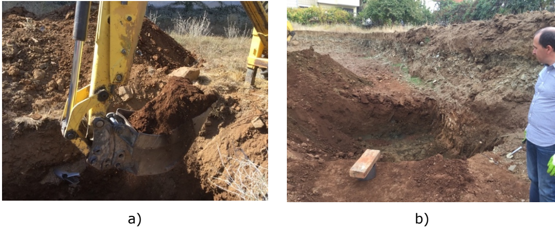
Figura 4.9 a) Solo com elevada percentagem de cascalho; b) Local de extração das amostras de solo A.
