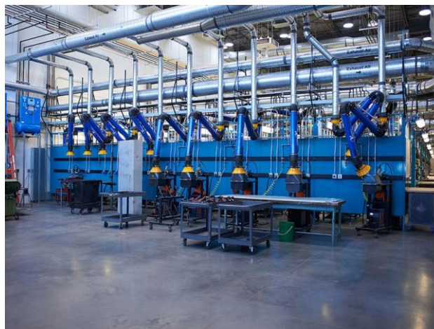
Figura 10 Oficina equipada com extrator de fumos [21]
