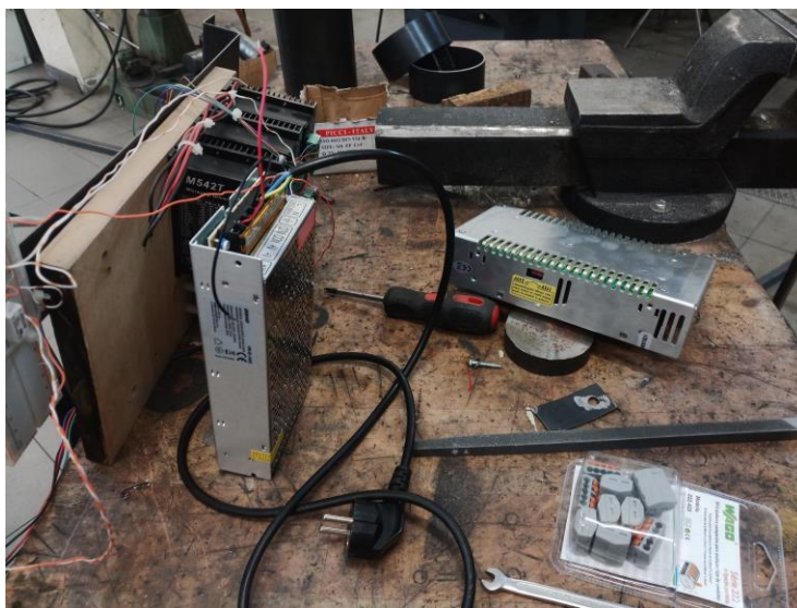
Figura 34 Parte do processo de substituição e otimização dos componentes elétricos
