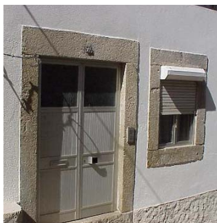
Figura 3.57 – Duas soluções a evitar em conjunto, porta em alumínio e estore de PVC
