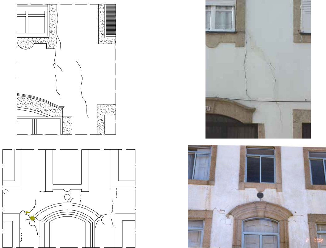
Figura 3.91 – Exemplo de fissuração junto aos cantos de janelas
