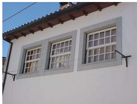
Figura 3.61 – Exemplo de má recuperação, utilizando granito polido em substituição do granito natural.
