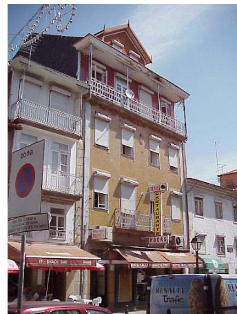
Figura 3.65 – Exemplo incorrecto de colocação de anúncios publicitários verticais e sistemas de ar condicionado na fachada
