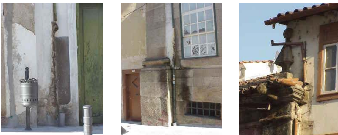
Figura 3.86 – Exemplos de tubos de queda incompletos
