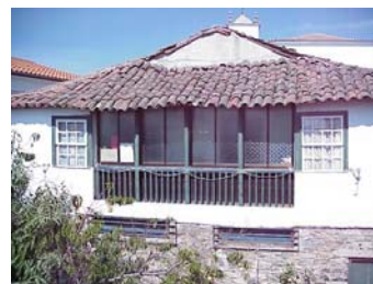
Figura 3.59 – Colocação de um envidraçado em alumínio de cor castanha pelo lado interior fechando a varanda.
