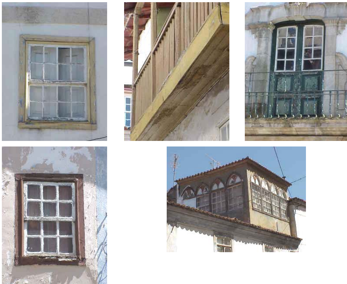
Figura 3.88 – Exemplos de deterioração da madeira em portas, janelas e varandas
