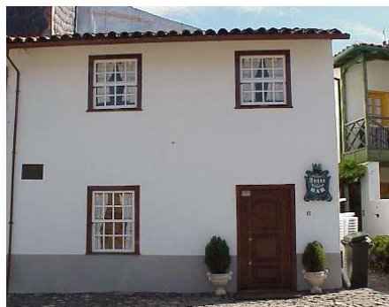
Figura 3.84 – Edifício da Cidadela recuperado segundo os materiais tradicionais e adaptado a restauração
