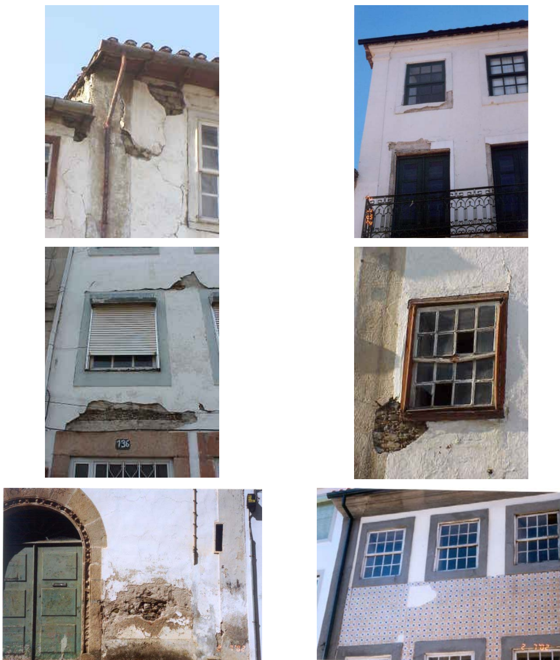
Figura 3.89 – Exemplos de destacamento de rebocos e revestimentos a azulejo
