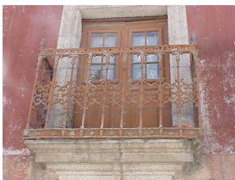
Figura 3.99 – Exemplo de oxidação de guardas das varandas
