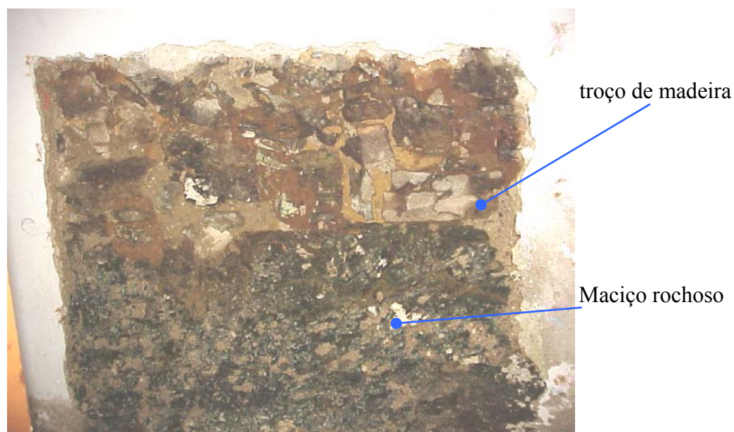
Figura 5.23 – Aspecto da alvenaria depois de retirado o reboco
