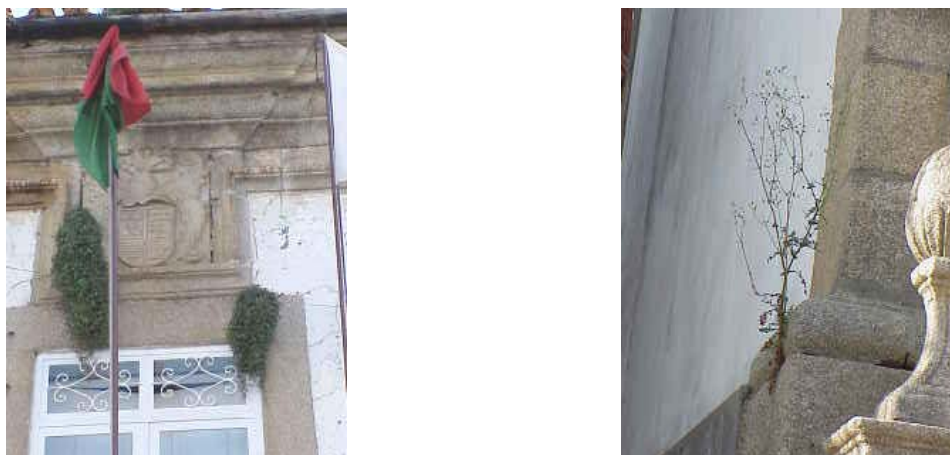
Figura 3.95 – Alteração do aspecto da fachada devido ao crescimento de vegetação
