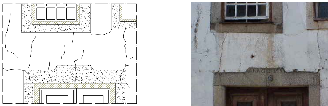
Figura 3.93 – Exemplo de fissuração bastante intensa
