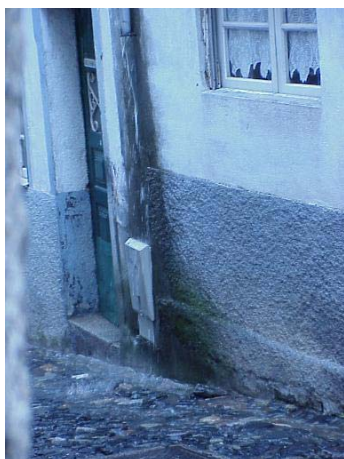
Figura 3.82 – Exemplo de um tubo de queda incompleto que despeja as águas por cima de uma caixa de electricidade
