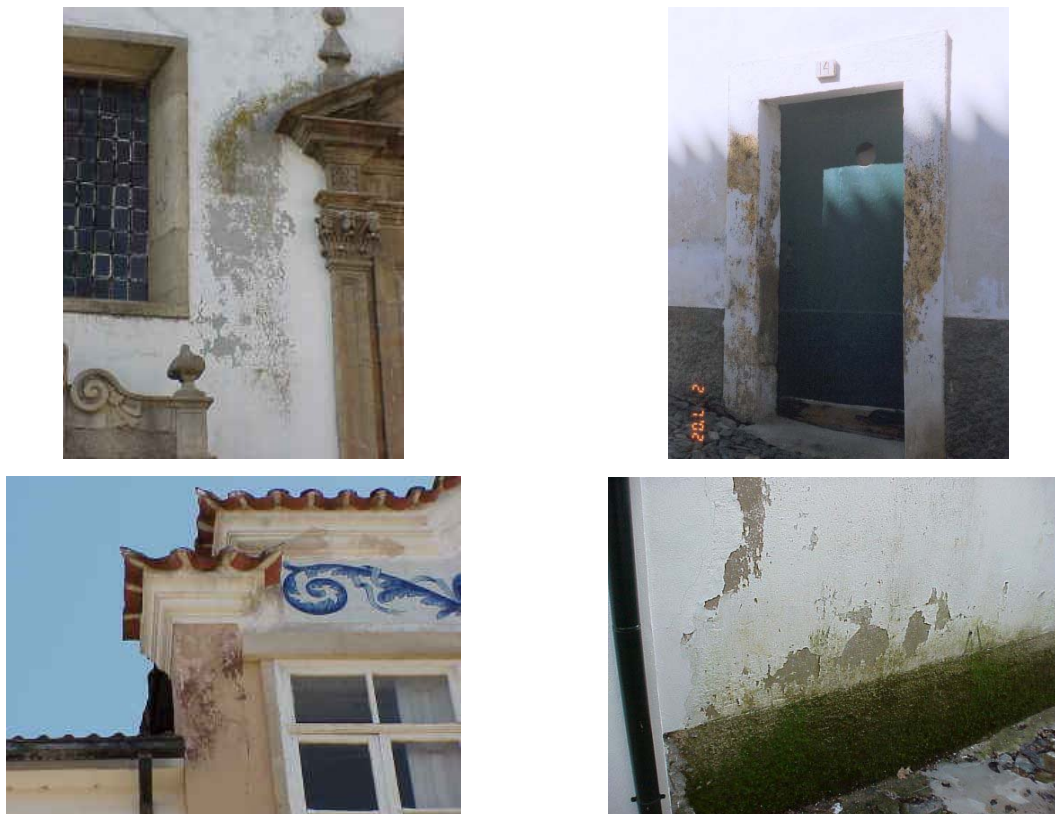
Figura 3.94 – Exemplos de alterações no revestimento superficial das fachadas
