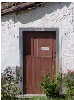
Figura 3.42 – Porta de entrada típica da Cidadela. De uma só folha, precedida de uma cancela exterior, também em madeira.
