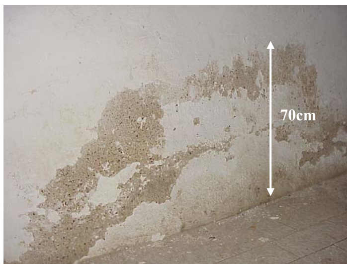
Figura 5.24 – Aspecto da parede com eflorescências
