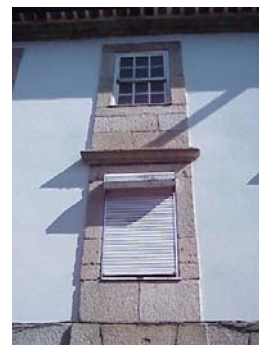
Figura 3.56 – Colocação inaceitável de estores de PVC sobre a caixilharia de madeira
