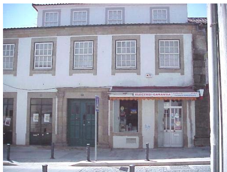
Figura 3.66 – Vista de parte do edifício completamente deformada. Portas de alumínio, montra em lugar de porta, gradeamento em ferro e pala
